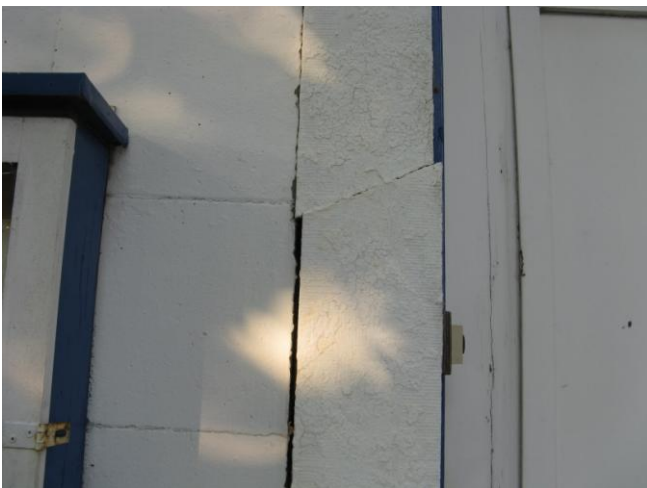
De gebarsten linker deurstijl
